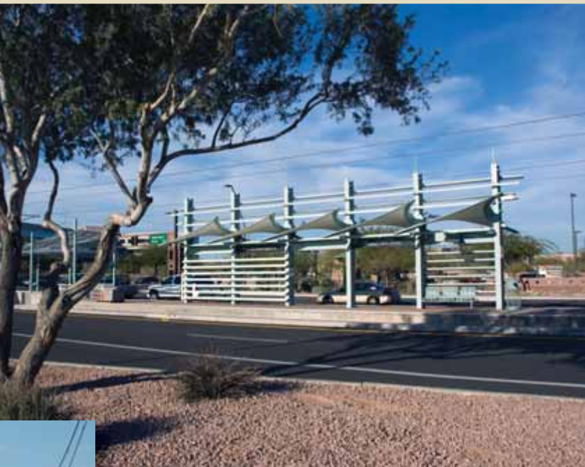
Station construction coming along at Priest Drive and Washington Street. La construcción de la estación avanza en Priest Drive y Washington Street.
