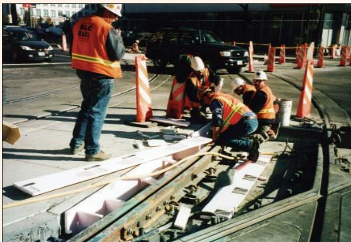
Track construction in Salt Lake City Construcción de rieles en Salt Lake City
