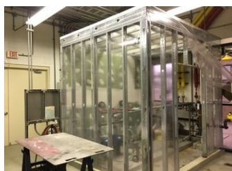
WRF Effluent Disinfection System
